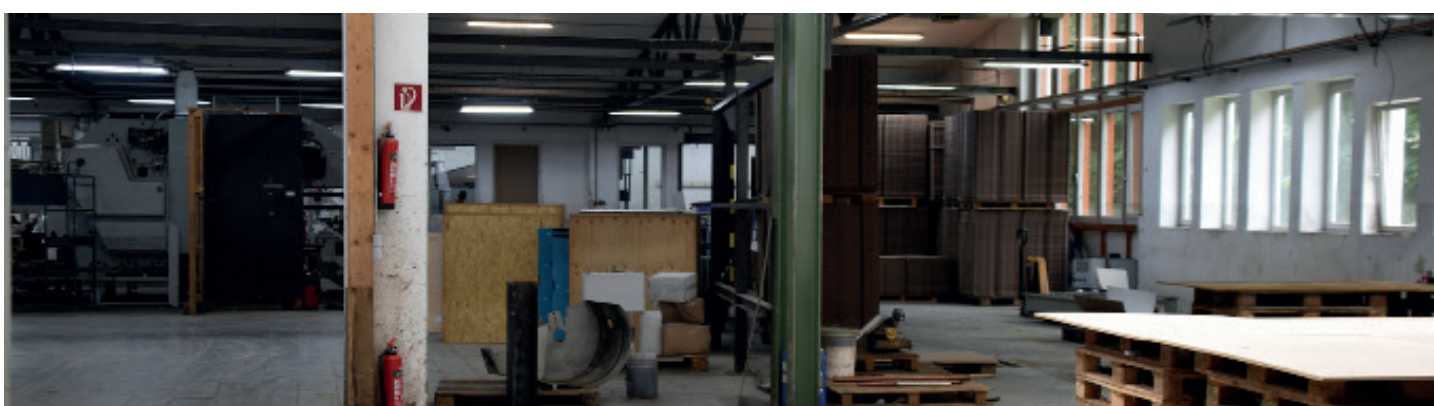
Vorher, nachher: Acht Wochen nach der Flutkatastrophe sind die Produktionshallen der Pappen Olef GmbH vom Schlamm und Müll befreit.
